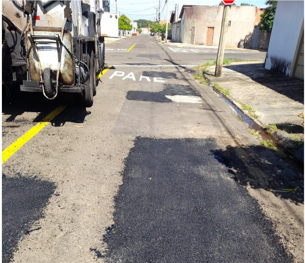
Execução de remendo asfáltico na Rua José Josué da Silva, Res. Jd. Vera Cruz
